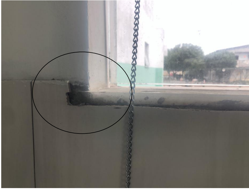
Figura 17. Acabamento mal executado na área entre cerâmica e peitoril de esquadria
