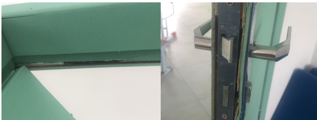
Figura 14. Utilização de esquadrias de madeira de baixa qualidade e má instalação, evidenciado pelo estado do alisar e área da fechadura da porta. Tais constatações indicam que as esquadrias terão baixa durabilidade.
