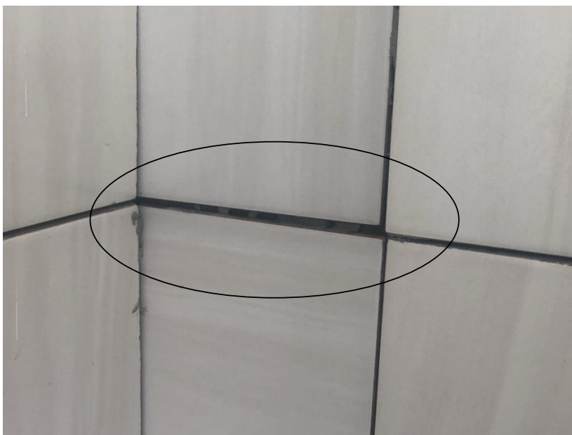
Figura 16. Revestimento cerâmico assentado em parede com acabamento mal executado. O espaçamento entre placas é irregular e não existe rejuntamento
