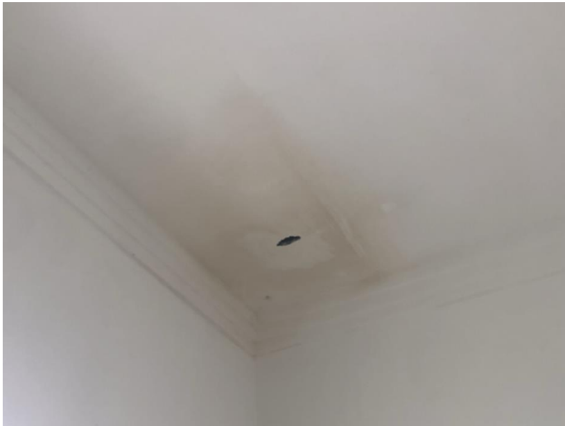
Figura 18. Indícios de infiltração em forro
