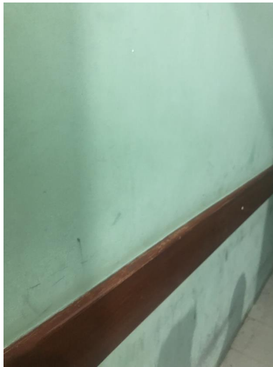
Figura 6. Trecho de alvenaria que deveria ter corrimão instalado (conforme indicado em Figura 5). Não foi observado na unidade nenhuma área em que os corrimãos previstos tenham sido instalados
