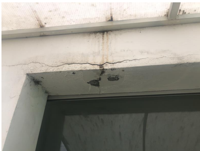
Figura 20. Fissura em área acima de esquadria da Ala Pediátrica
