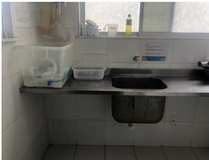
Figura 12. Expurgo sem a instalação de bancada de granito prevista em projeto (conforme indicação da Figura 11)
