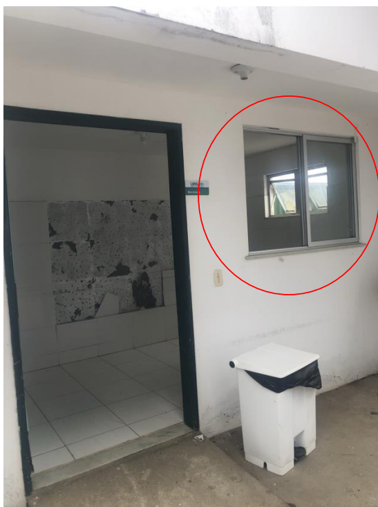
Figura 8. Necrotério sem a alteração da esquadria conforme previsto em projeto básico (apresentado na Figura 7)
