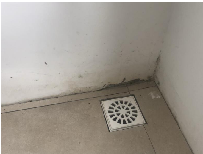
Figura 13. Indícios de infiltração de água na parte inferior de parede do banheiro da Ala Pediátrica
