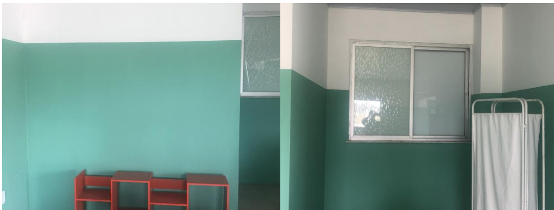
Figura 4. Áreas da Ala Pediátrica que deveria ter interligação com a edificação preexistente (indicado na Figura 3). Tais interligações não foram realizadas.
