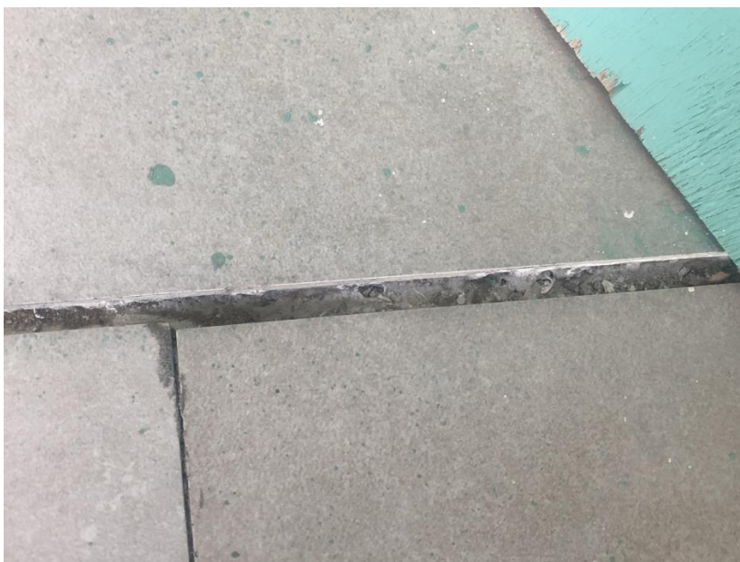
Figura 15. Revestimento cerâmico assentado em piso com péssimo acabamento. O espaçamento entre placas é irregular e não existe rejuntamento
